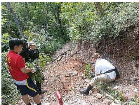
地割れに草や枝を入れて復旧
