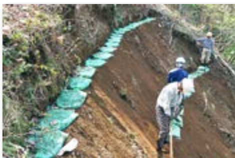
土砂崩壊防備
